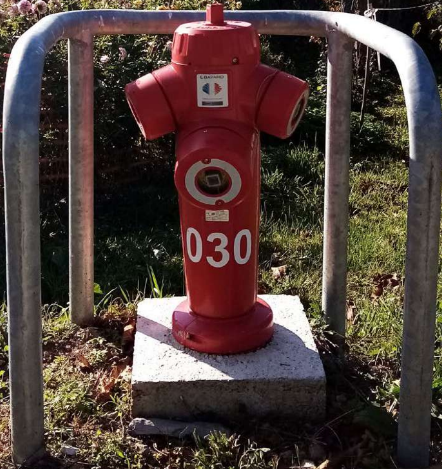
↑ Poteau Incendie et son arceau posés dans les règles de l'art
