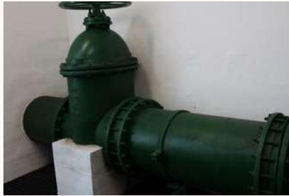
← Station de pompage Mails - St-Égrève
