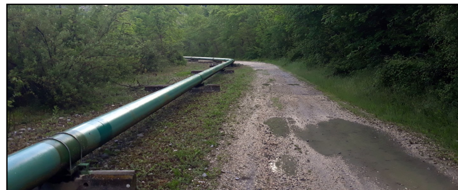
Canalisation d'acide chlorhydrique à Champagnier
